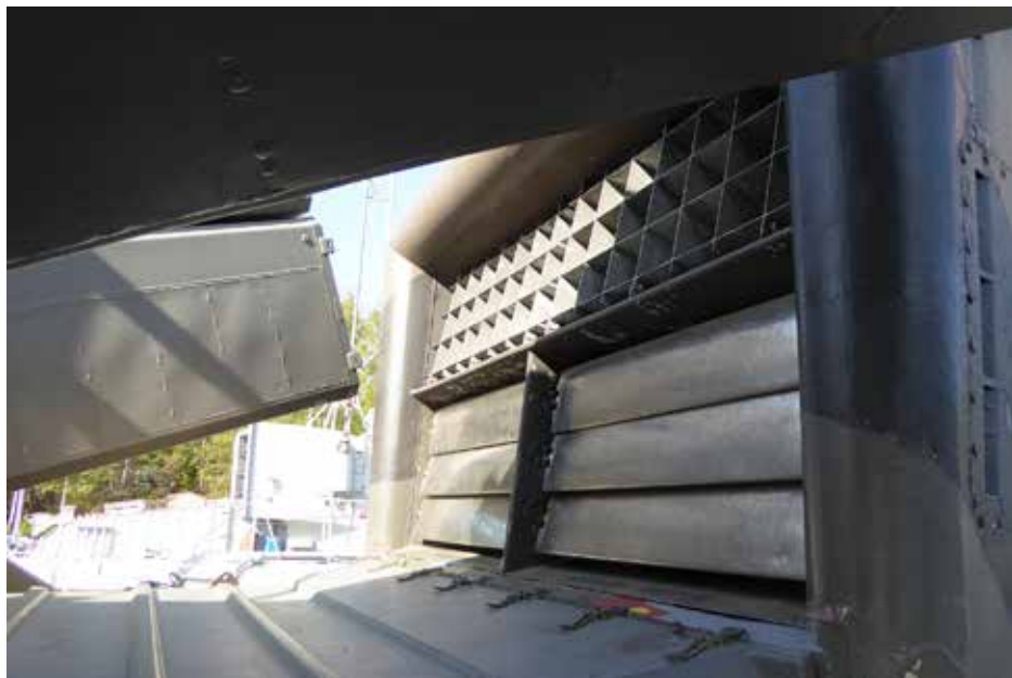
Luftindtag til turbinerne, 100 kubikmeter i sekundet.
